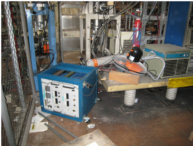
図1 高電圧架台から電源落下
