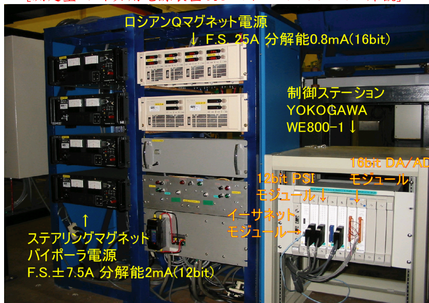
[測定室マグネット用電源装置及びコントロールモジュールの外観]
