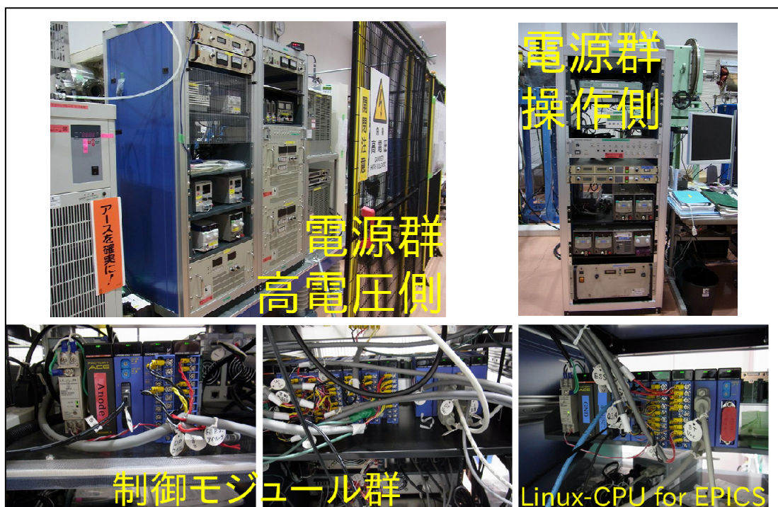
図8 筑波大 PIS で使用している制御系ハードウェア
